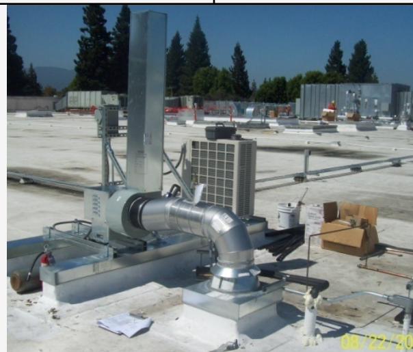
Fan on rooftop
