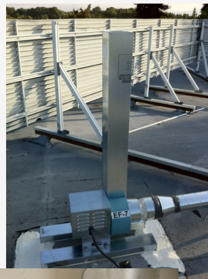
Fan on rooftop
